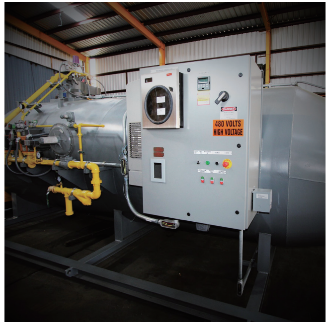
图1 ❖ 作为三级热回收装置的废热热水器，利用烟道废气中的多余热能产生清洁金属条所需的热水。
